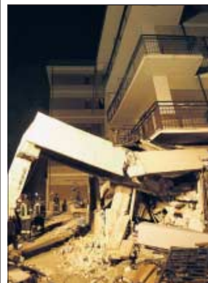
Das zerstörte Studentenwohnheim. (AP)
